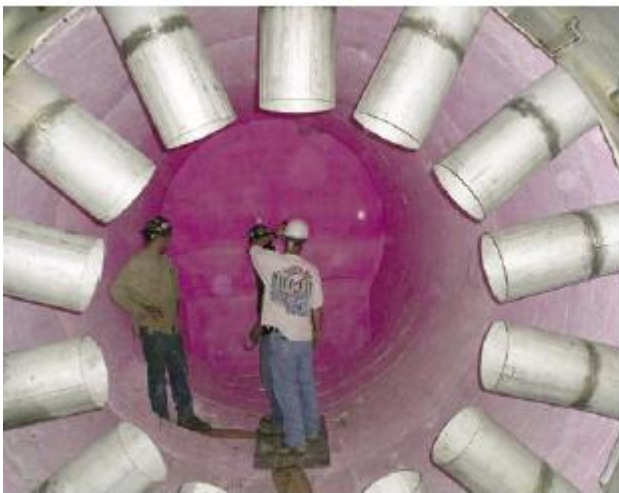
Thermal oxidizer til avanceret luftrensning (fra Jennings 2005)
